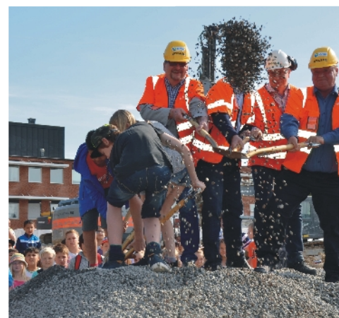
Det var fullt fokus och jubel när de första spadtagen togs av eleverna Isak Granström, Alice Englund och Kalle Wierenberg samt av Pelle Strengbom (S), Mikael Peterson (S), Per-Inge Edlund, (PEAB) och Hendrik Mayer (L).
