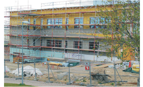
Bygget av nya skolan går enligt plan och just nu pågår arbetet med träpanelen.
